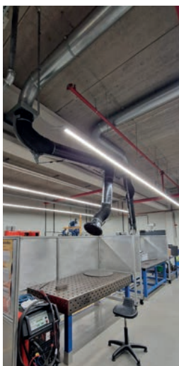
Bras d'extraction reliés à une unité centrale de filtration
